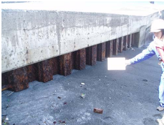
矢板式突堤の劣化(鋼矢板の腐食)状況
