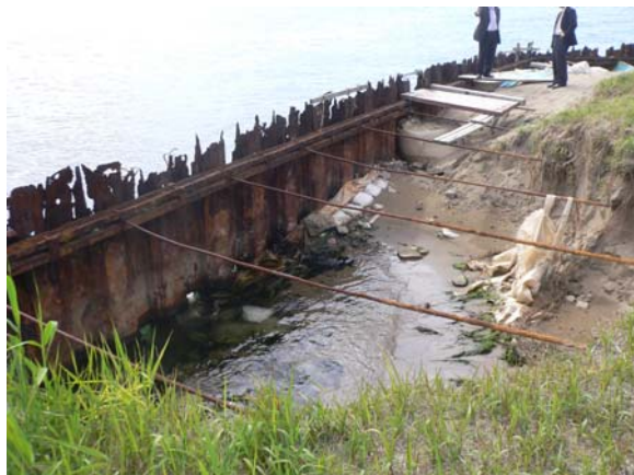
矢板式岸壁の劣化(腐食・吸出し)状況
