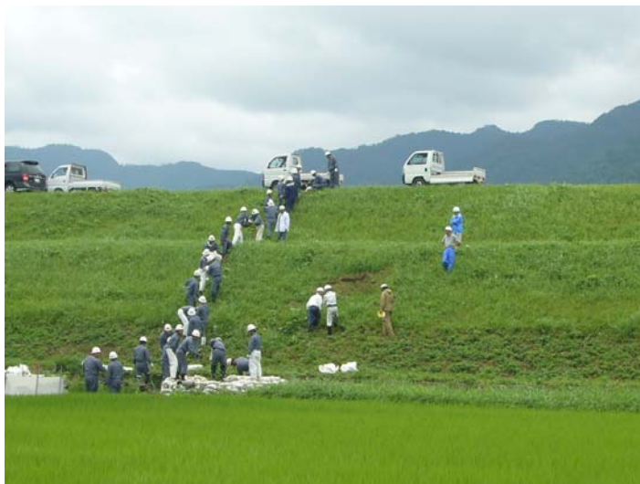
居住地側の堤防斜面の変状 (平成 18 年 7 月 斐伊川)
