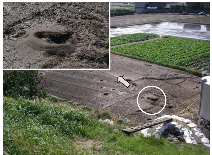
堤防の居住地側の噴砂 (平成 16 年 10 月 那賀川)
