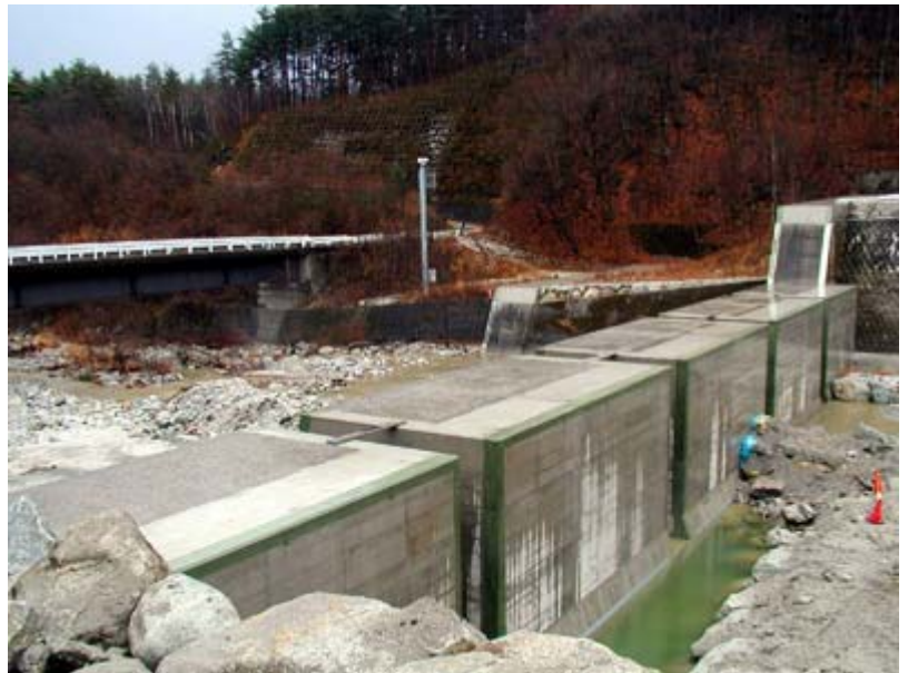
関東地整富士川砂防管内 尾白川第3砂防ダムえん堤スリット化工事中
