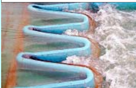
ラビリンス型越流堤(越流式放流設備)
