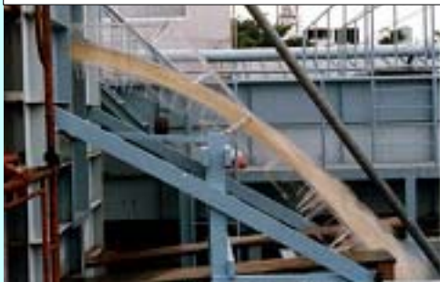
オリフィス(管路式放流設備)
